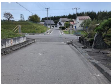
道路の被災状況
