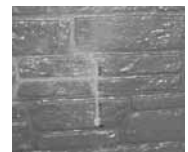
写真1 亀裂の設定例
