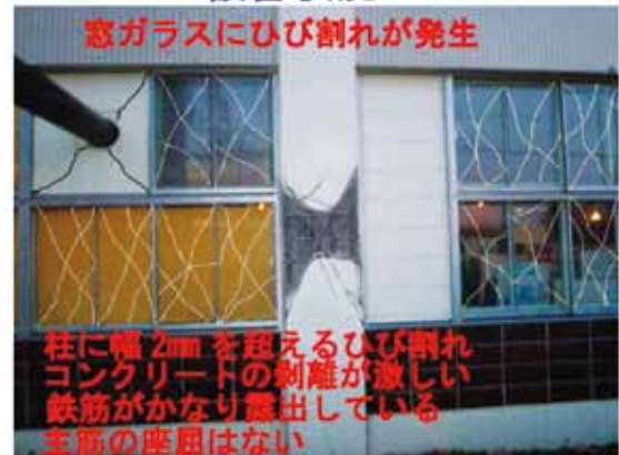
机上訓練の例（柱被害と窓ガラスのひび割れの判断）
