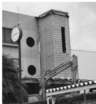
c) E V棟の損傷
