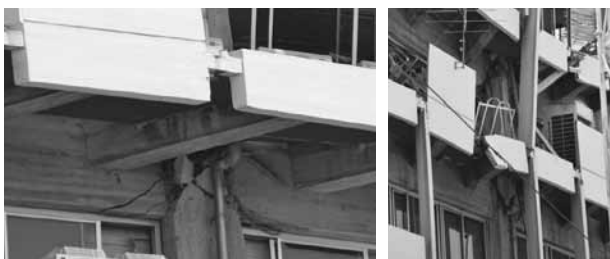
b) 柱梁接合部の破壊
