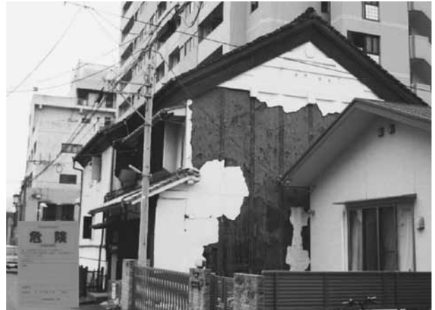
写真8 外装材の脱落による危険判定
