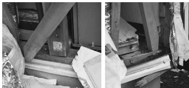
写真2 接合部金物の不使用
