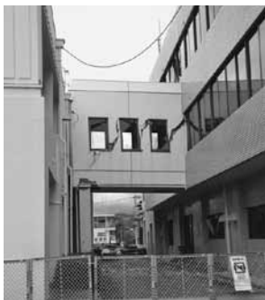
b) 渡り廊下の損傷
