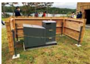
屋外の消防設備
