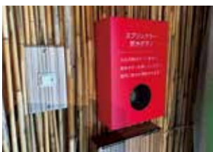
チセ内の消防設備
